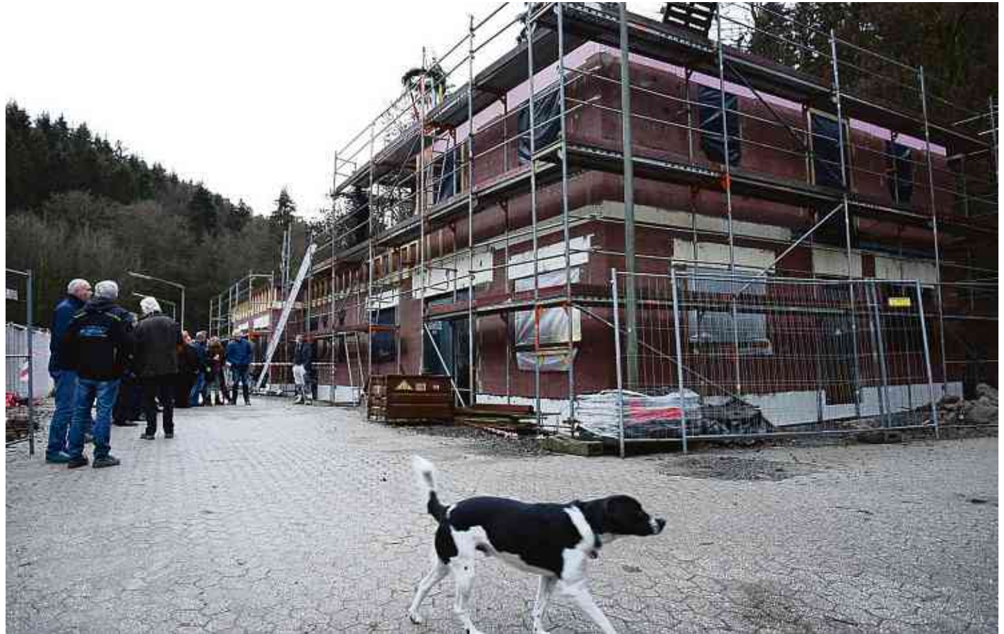
Das neue Tierheim entsteht in Wiehl-Koppelweide. Ehrensache: Beim Richtfest erschienen auch Vierbeiner.
